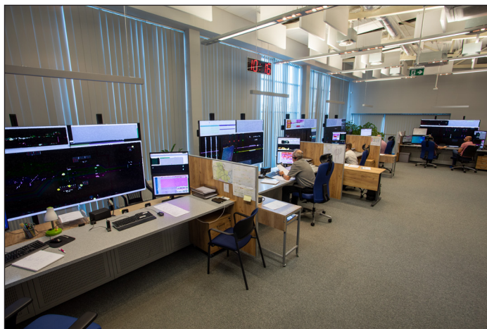
PGE Energetyka Kolejowa - Sopot
