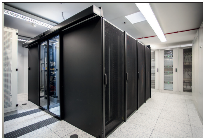
Data Center - PCS (Poznańskie Centrum Superkomputerowe)
